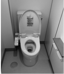
▲洋式化された学校のトイレ（愛宕台中学校）
