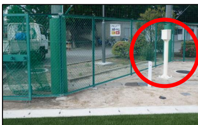
（夜間照明設備操作盤）
