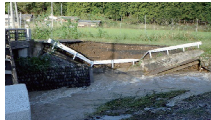
春日橋付近の護岸洗掘(小俣町)
