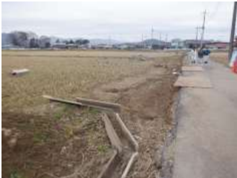
稲岡町 農業用水路破損
