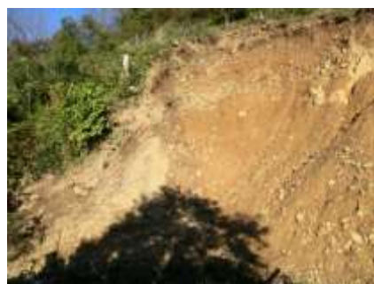
土砂災害箇所(樺崎町)
