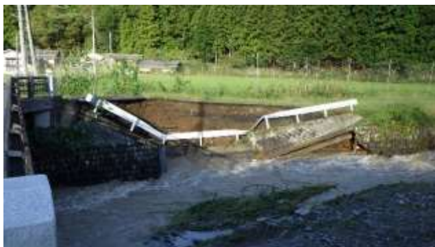
小俣町 春日橋付近の護岸洗堀
