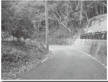
大岩町地内 ▶被災時 ▼復旧後
